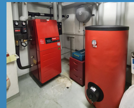
Ölheizung EFH / MFH
