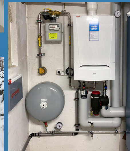
Gasheizung EFH / MFH
